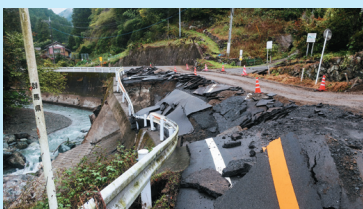
甘楽町秋畑-護岸の下部から水が土を浚い、県道が崩落
